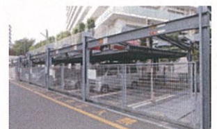
立体駐車装置
